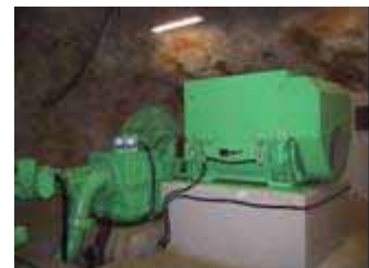
釜石鉱山マイクロ水力発電所 450kW
